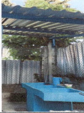
Foto 1: Sustitución de pila, soporte de estructura de metal más lámina troquelada M 1.
