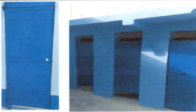
Foto 3: Sustitución de puerta en aula 3 del M 3. Y sustitución de puertas en servicios sanitarios.
