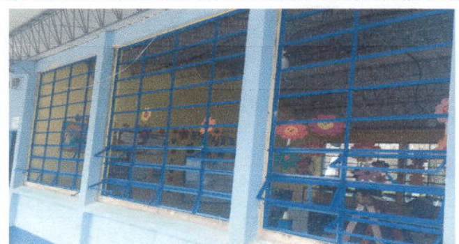
Foto 6: Ventanas de metal tipo balancín Aula 2. M 1.
