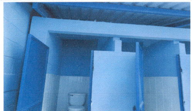
Foto 4: Ampliación, remodelación y colocación de azulejo en área de servicios sanitarios M 1.
